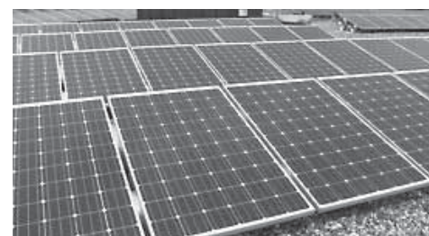
Erzeugt saubere Energie: Photovoltaik-Anlage im Schwäntenmoos
