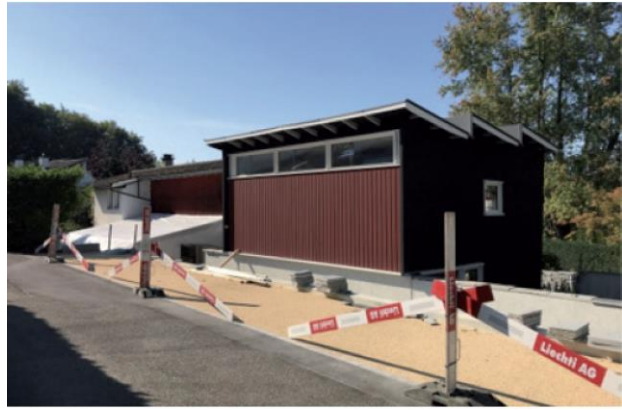
Holzbauanbau mit Kollektoren, Tobelhusstr. 11
