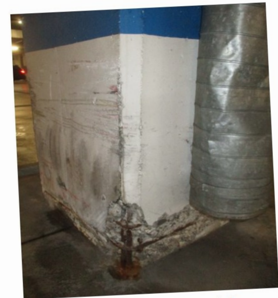
Bewehrung / Armierung rostet
