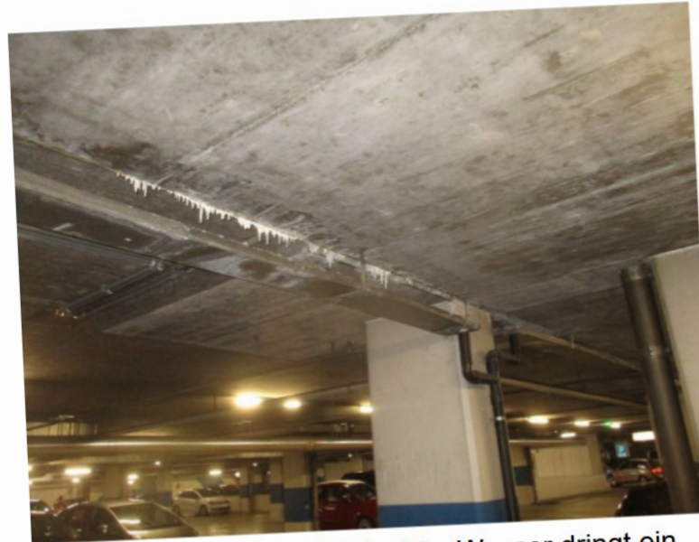
Abdichtung zum Dorfplatz leckt – Wasser dringt ein
